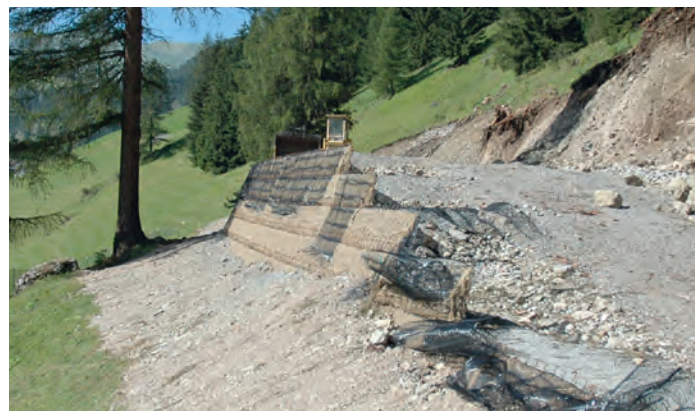
Stanno procedendo i lavori di protezione da caduta massi nella zona "Pralonch"
