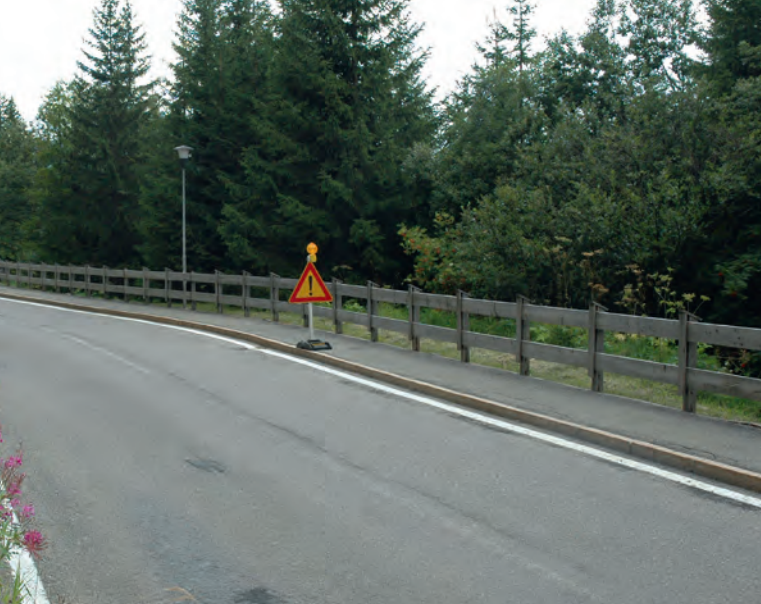
Negli ultimi mesi la strada "La Sëlva" ha subito alcuni cedimenti nella scarpata e deve quindi essere risanata e stabilizzata.
