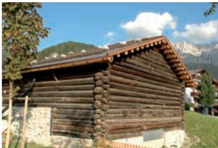
Il progetto per la ristrutturazione del "Tublà da Nives" prevede una spesa complessiva di Euro 1.592.654,00
