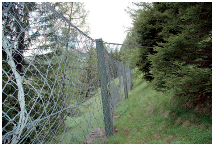
Le barriere di protezione paramassi a Plan verranno prolungate.
